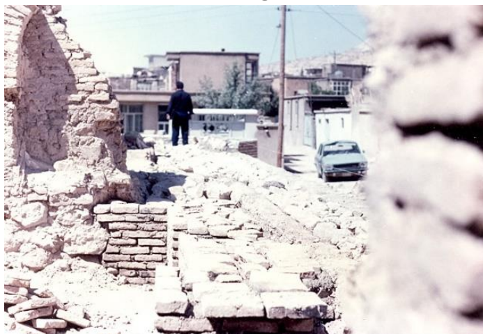
تصاویری از کاخ والی پس از تخریب
